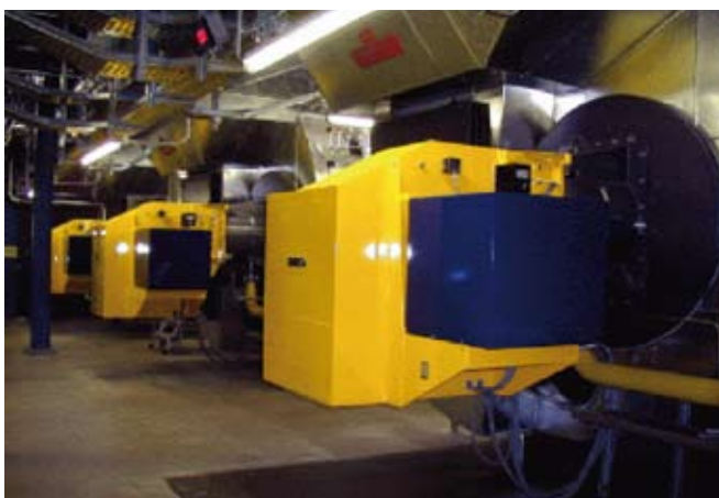
Flammrohrkesselanlage in Goslar
