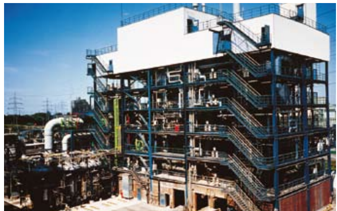
Abfallverbrennungsanlage VA3, Leverkusen
