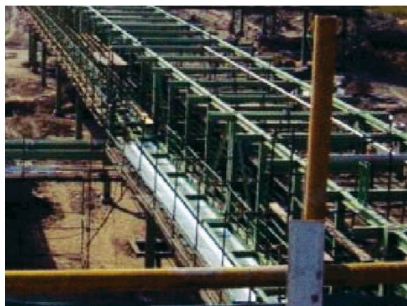
Rohrbrücken sind zentrale Versorgungsadern von Industrieanlagen
