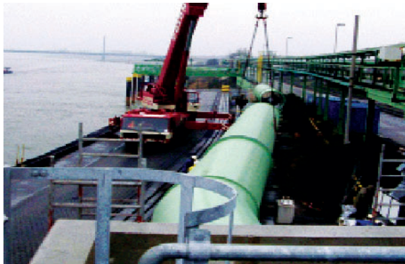
Hochwasserpumpwerk mit Überleitung DN 2400
