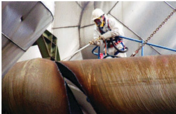
Trennung von Anlagenteilen
