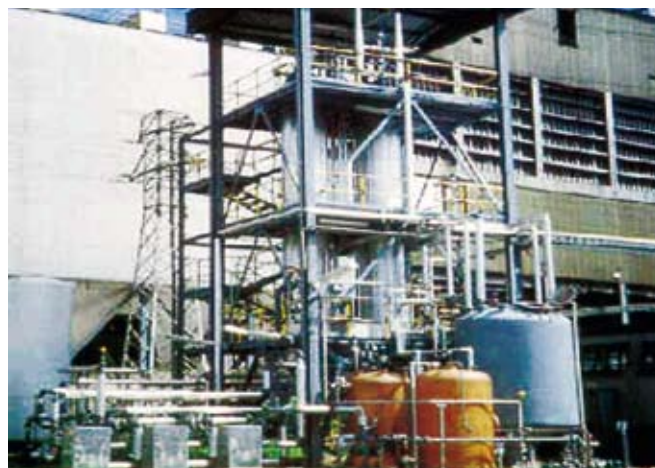
LOPROX®, завод в Ла Фельгуэре (Испания)
