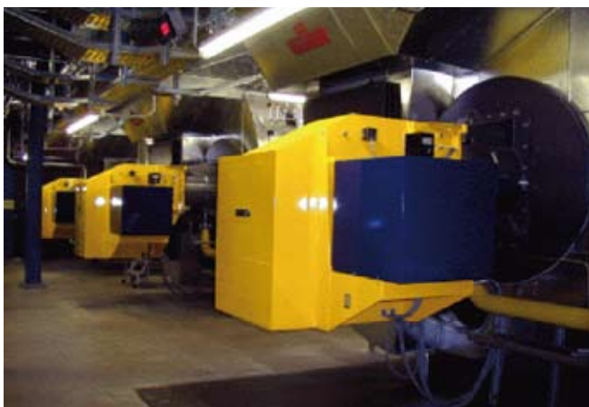
Установка с жаротрубным котлом в Госларе
