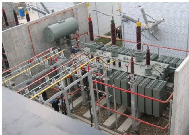
Сетевой ввод 220 кВ для трансформатора мощностью 20 МВА в Кайоджинге, Китай
