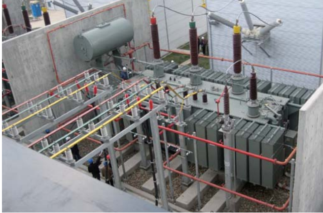
220-kV-Netzspeisung für einen 200-MVA-Transformator in Caojing/China
