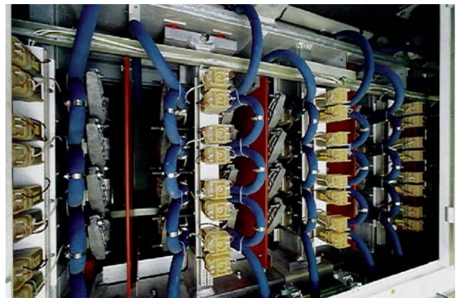
ABB Gleichrichter für einen Strom von 50000 A in Krefeld-Uerdingen, Deutschland
