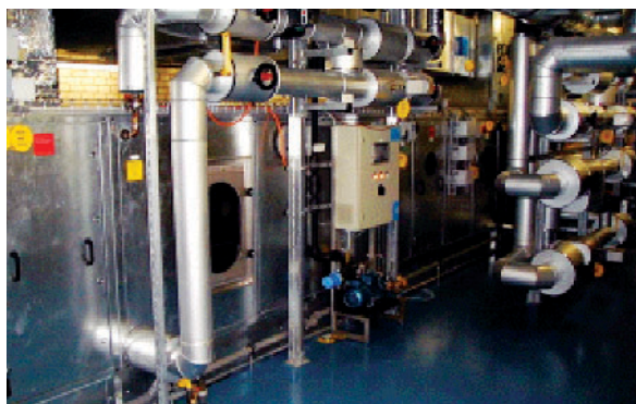
Technikzentrale im Laborgebäude 460 ELB, Bayer AG
