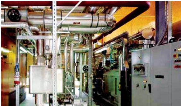
Technikzentrale – CC-Aspirin-Produktionsbetrieb Pilar/Argentinien
