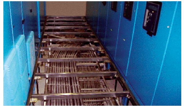
6 MW-Stromversorgung (NYGWY-Kabel vom Typ 4x240/120 mm, Ø 65 mm) Doppelboden Rechenzentrum ScaleOn GmbH der Bayer AG
